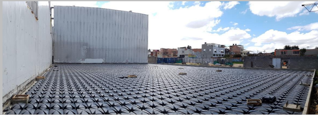
RANSA COLFRIGOS , Fontibón – Bogotá 1,600m 2 . Edificio frío negativo
